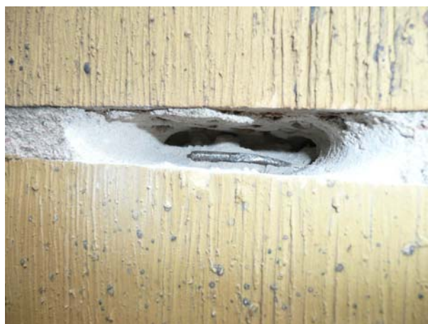
Bild 3.21. Rostfri kramla i den nyare delen av fasaden.
