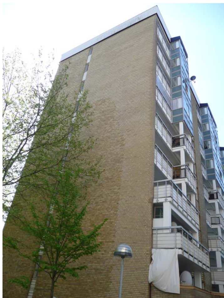
Bild 1.3. Renoverad gavel på Rosengård i Malmö med nytt tegel till höger och gammalt till vänster.
