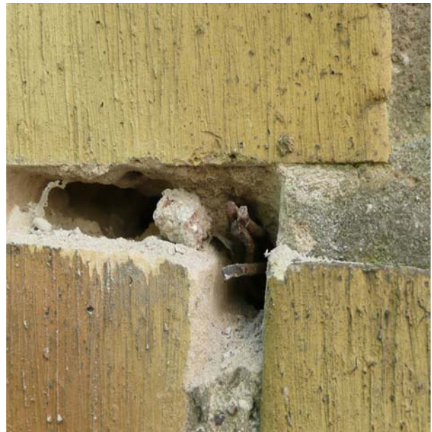
Bild 3.20. Rostig kramla av metalltråd i den gamla delen av fasaden.
