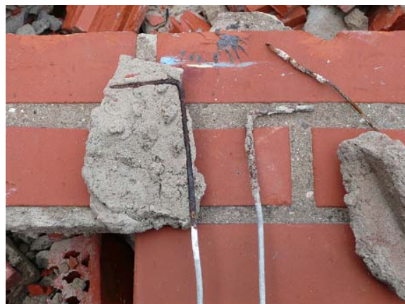
Bild 1.1. Exempel på rostiga kramlor från en riven fasad i västra hamnen, Malmö.
