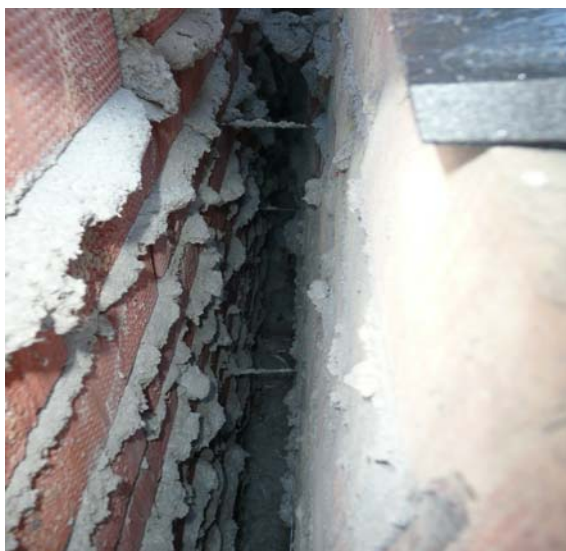
Bild 3.13. Rostfria kramlor i kanalmur från Limhamn i Malmö.
