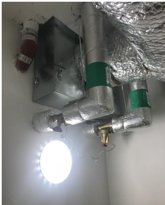
Figur 13 - Kollisioner mellan installationer
