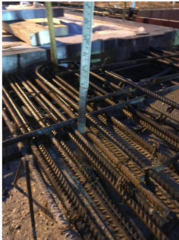
Figur 15 - Ventilation kolliderar med balkongarmering
