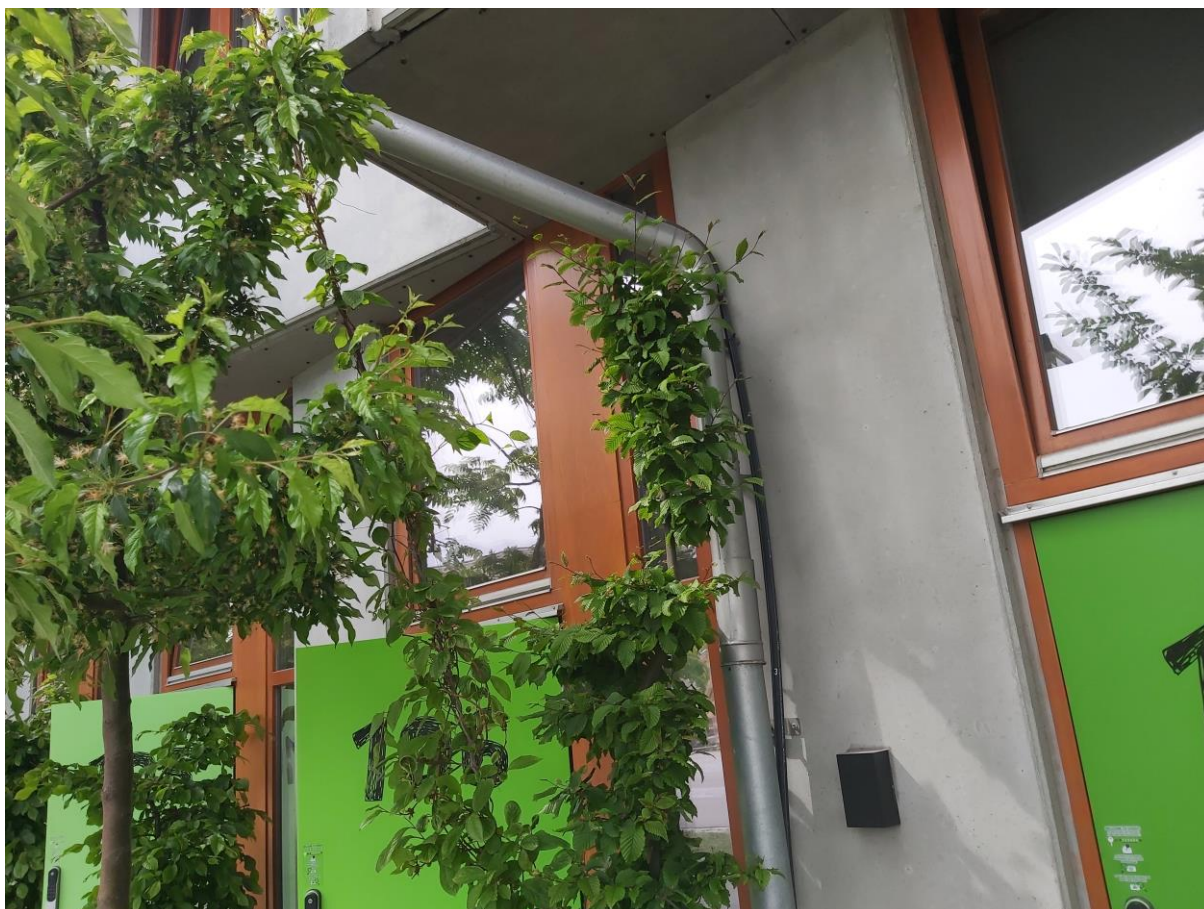
Bild 11. Ohboy, bevattningsledning gömd bakom stuprör.
